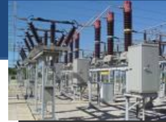
Proyecto: "Nueva Subestación"
